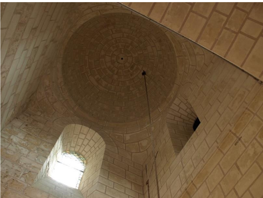
Figure 52. Intérieur du clocher avec sa coupole de pierre. Remarque importante : noter la présence d'une baie non éclairée ; elle donne sous la charpente du chœur, et permet d'accéder dans les sous-pentes. Cela ne justifie pas son existence ; elle est identique à la baie Est. Initialement, cette baie aveugle donnait au Sud, vers l'extérieur, apportant lumière et clarté. Sa présence démontre que le choix de la forme actuelle de la charpente du chœur fut tardif et décidé après l'érection du clocher.
