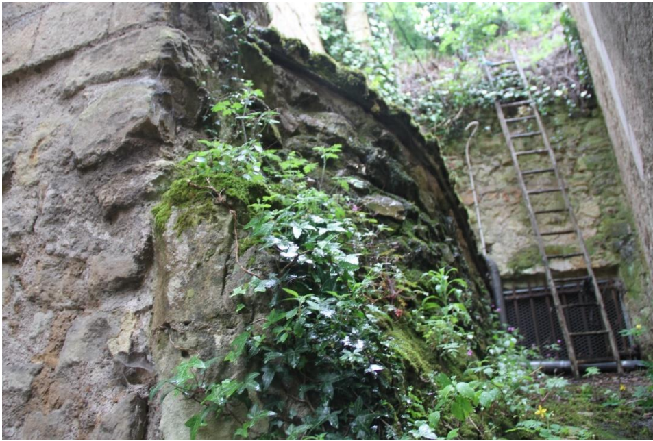
Figure 32. Appuyé sur l'ancien contrefort, un mur cylindrique semble former le chevet d'une chapelle
