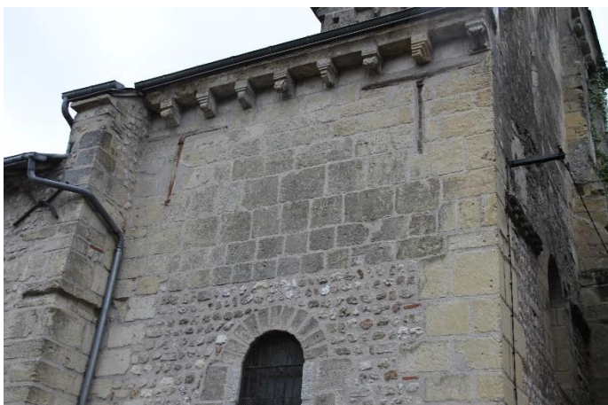
Figure 49 Le passage de « petit appareil », en « moyen appareil » avec les moellons plus importants, renseigne sur les modifications apportées sur le haut du chœur.
