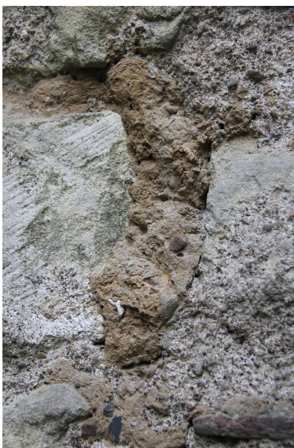
Figure 31. On peut constater la présence de joints en argile, certaines fractions ont été recouvertes de ciment : réalisation probablement tardive avec une motivation de protection
